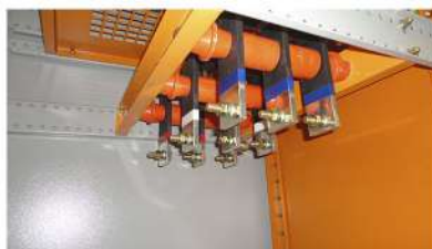
Entrada de cabos
